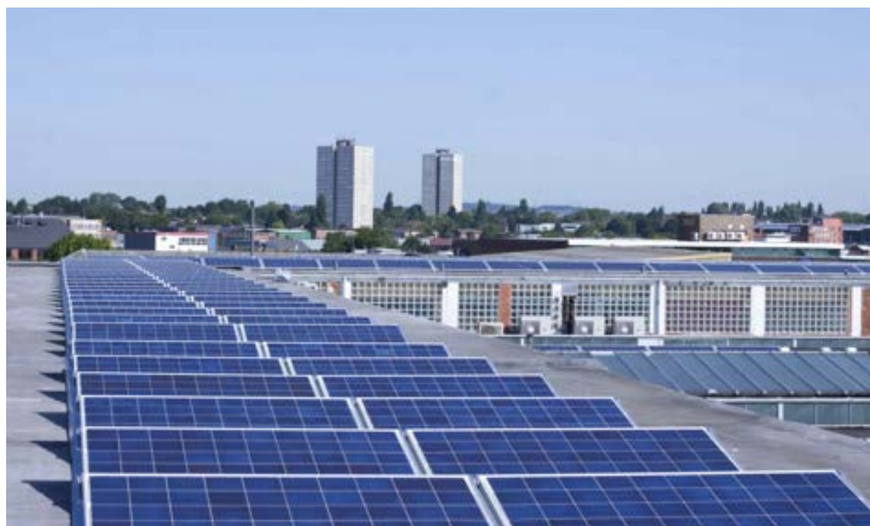
Slika 8-78. Solarni paneli na krovovima objekata (Izvor: Nerpower)
