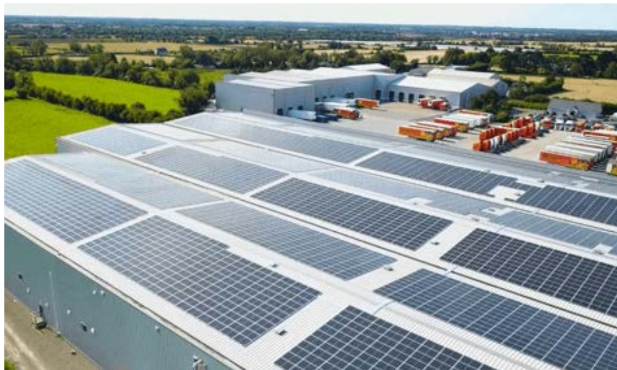
Slika 8-77. Solarni paneli na krovovima objekata (Izvor: Sam-Dennigan-and-co-roof-top-solar-E)
